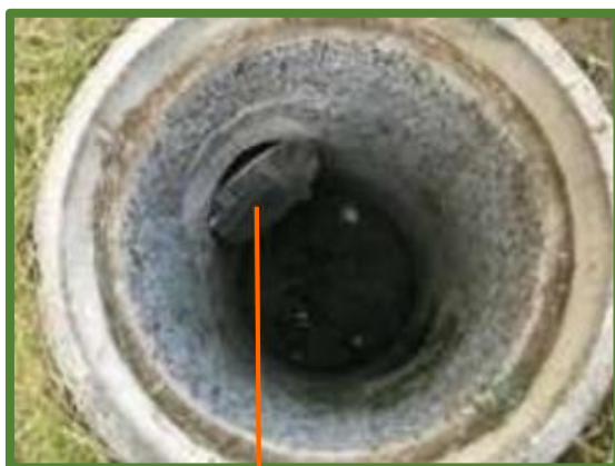
① 排水管接合部の金網
